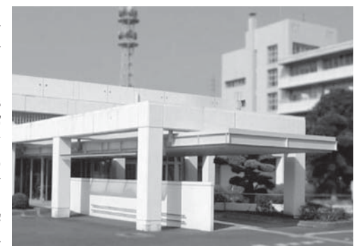
▲建築から32年たち、老朽化が進む障がい者スポーツ・レクリエーションセンター。冷暖房設備もなく、早急な改善が必要。
